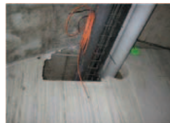
Fot. 2: Nieszczelność wewnętrzna: przepust kablowy pomiędzy sąsiadującymi ze sobą pomieszczeniami składowymi budynku (Źródło: IngBEU).
