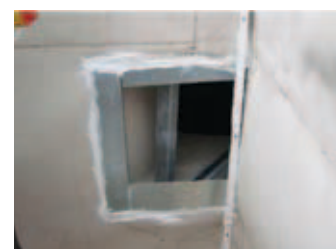
Fot. 3: Otwór kanału dymowego w szybie windy (Źródło: IngBEU)
