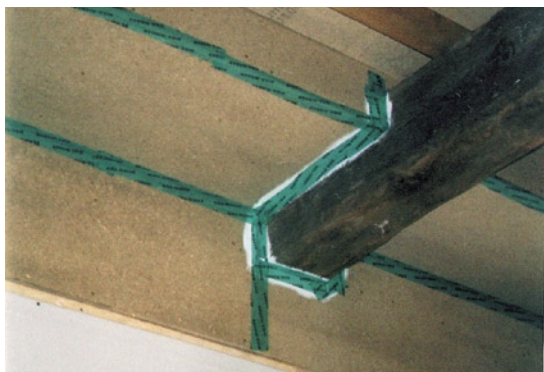
6 i 7: Projekt i wykonanie prac modernizacyjnych w przypadku pełniących rolę łączników belek stropowych
